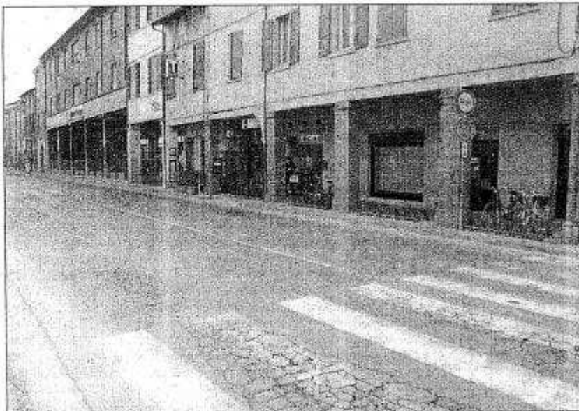
Il tratto della via Emilia nei pressi della piazza, dove è ben visibile il danneggiamento del manto stradale (Foto Franco)
